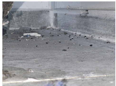
Spor av mus på gulv under dusjkabinett.
