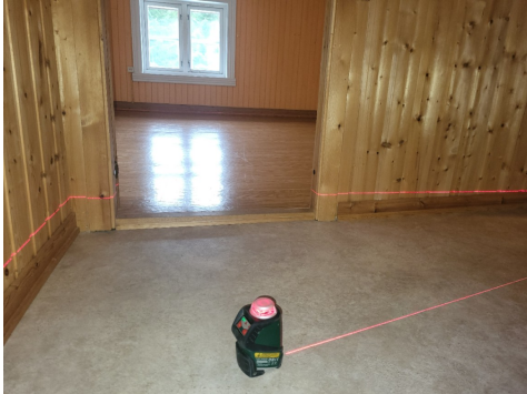
Skjevheter i gulv på loft.
