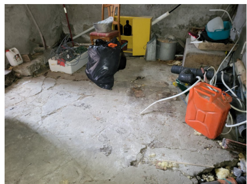
Sprekker i gulv.
