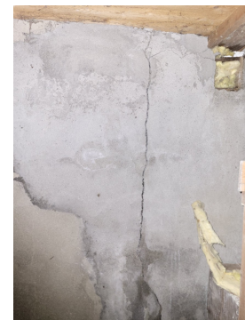
Innvendig sprekk i tresnitt mot grunnmur.
