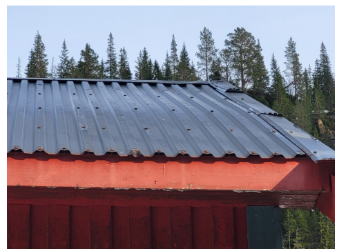
Kul på utvendig tak. Rust på takplater.
