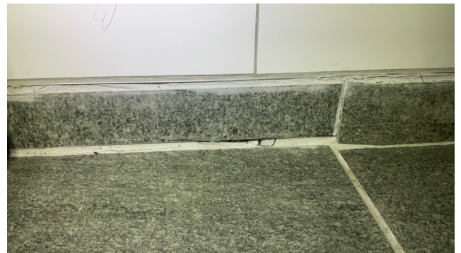
Sprekk i fugemasse i dusjsone.
