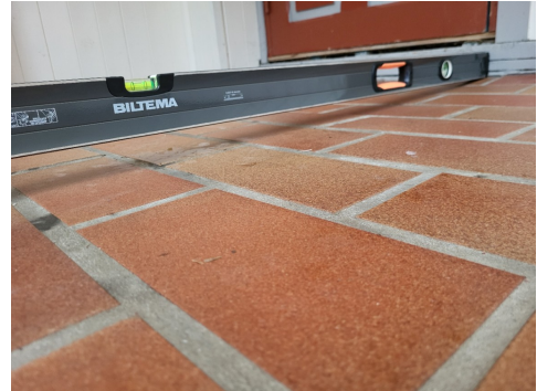
Skjevheter i gulv.
