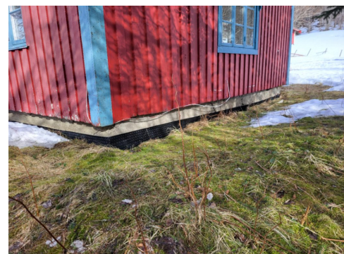
Synlig skjevhet på utsiden av muren mot sør.
