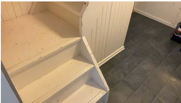
Slitasje i trinn.
