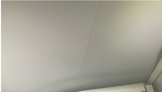
Skade i himling
