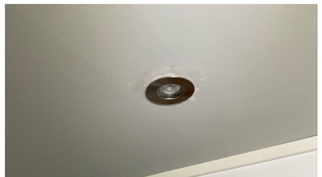
Skade i himling ved en spot
