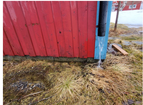
Manglende overvannsrør under bakkenivå
