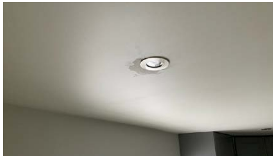
Skade ved spot i himling på kjøkken.
