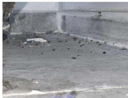
Spor av mus på gulv under dusjkabinett.
