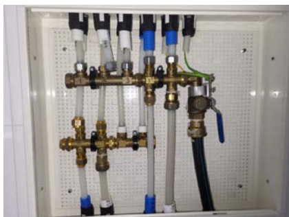
Rørskap på bad.
