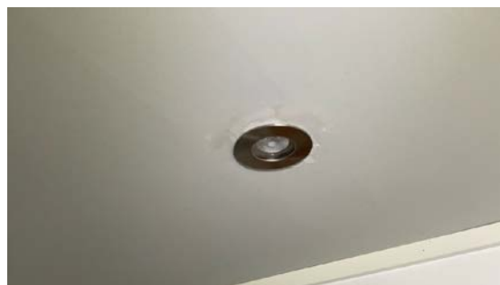
Skade i himling ved en spot
