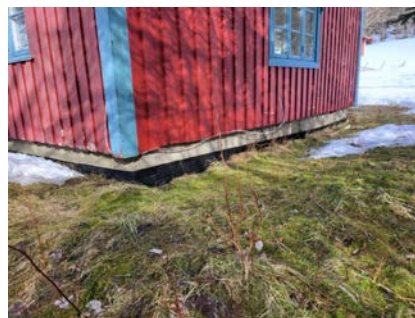
Synlig skjevhet på utsiden av muren mot sør.
