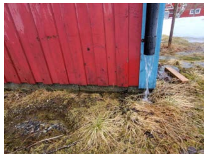
Manglende overvannsrør under bakkenivå
