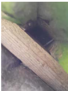
Det er ingen musesperre i nedre kant av konstruksjon.
