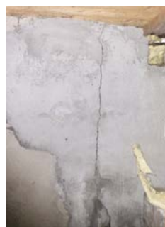
Innvendig sprekke i tresnitt mot grunnmur.
