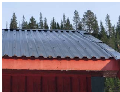
Kul på utvendig tak. Rust på takplater.
