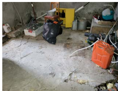
Sprekker i gulv.
