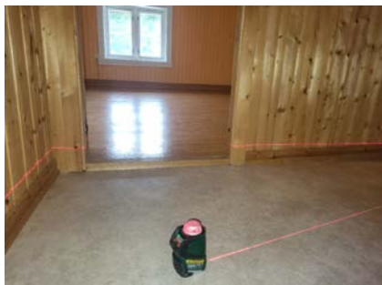
Skjevheter i gulv på loft.
