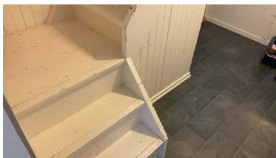
Slitasje i trinn.
