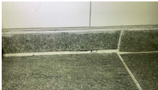
Sprekk i fugemasse i dusjsone.
