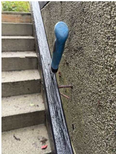
Råte i håndrekke.
