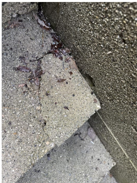
Riss/sprekk utv. trappetrinn
