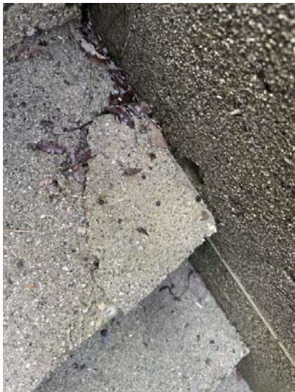
Riss/sprekk utv. trappetrinn
