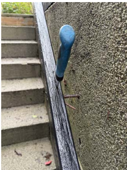
Råte i håndrekke.
