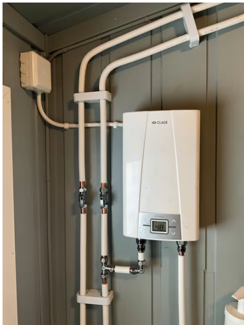
Viser bereder plassert på sanitærrom for bruk internt i rommet.
