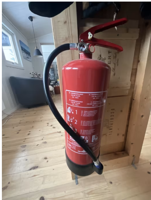
Viser brannslukningsapparat fra 2021.
