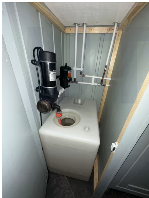
Viser plastdunk og vannpumpe i sanitærrom.
