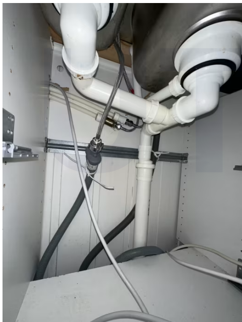
Viser vann og avløpsinnstallasjoner under kum. Rørøppheng fremstår som en provisorisk løsning.
