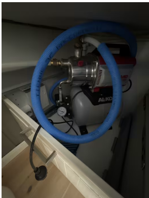
Viser vannpumpe plassert i skap på kjøkkenet.
