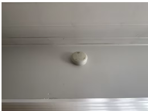
Viser brannvarsling montert på drager i stue.
