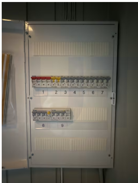
Viser sikringskap på soverom.
