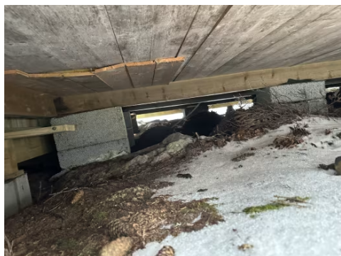
Stubbloftshimling med trebord ved opprinnelig del. Synlig sprekk/åpning i stubbloftshimling med trebord.
