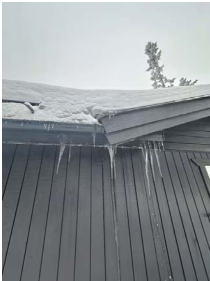
Det registreres istapper på taket og ved luftingen av taket.
