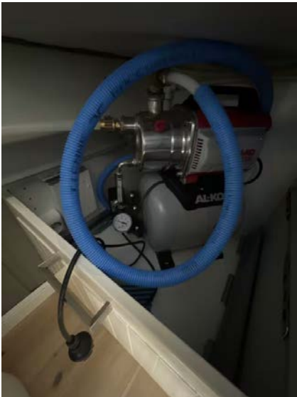
Viser vannpumpe plassert i skap på kjøkkenet.
