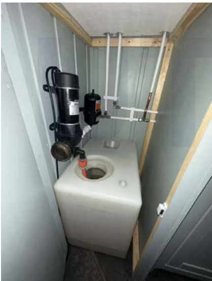
Viser plastdunk og vannpumpe i sanitærrom.
