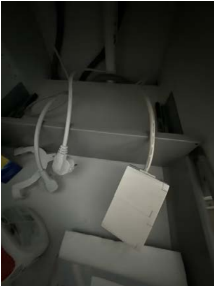
Det registreres løs stikkontakt i skap under kum. Kontakt må festes tilstrekkelig.
