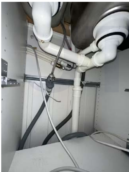
Viser vann og avløpsinstallasjoner under kum. Røroppheng fremstår som en provisorisk løsning.
