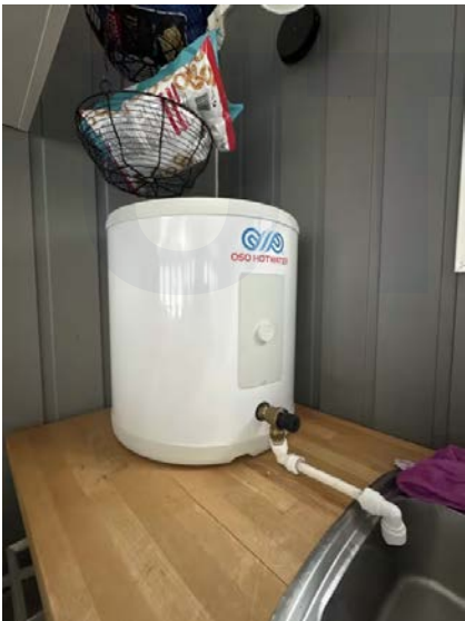
Viser bereder plassert på kjøkkenbenk for varmtvann på kjøkken.
