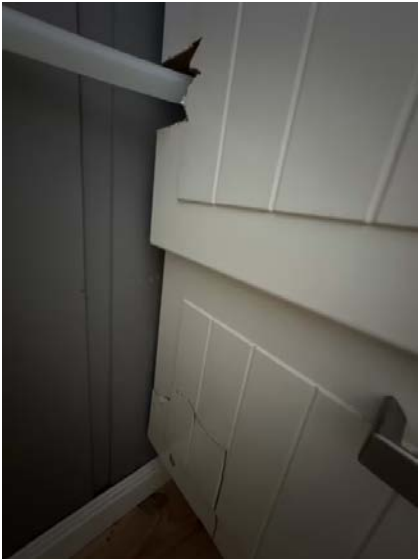
Viser skade på front og grov utskjæring for vannrør.
