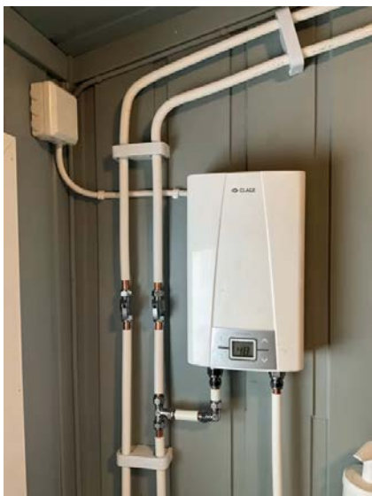
Viser bereder plassert på sanitærom for bruk internt i rommet.
