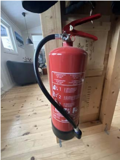
Viser brannslukningsapparat fra 2021.
