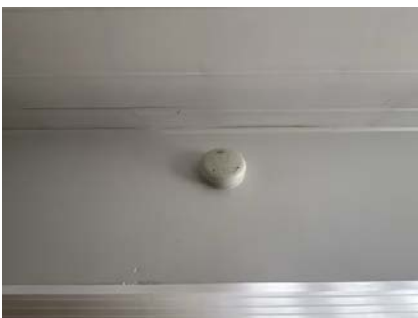
Viser brannvarsling montert på drager i stue.
