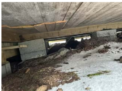
Stubbeloftshimling med trebord ved opprinnelig del. Synlig sprekk/åpning i stubbeloftshimling med trebord.
