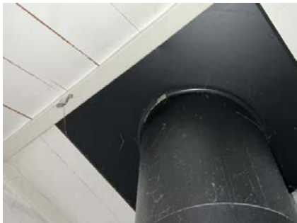
List rundt pipa må undersøkes.
