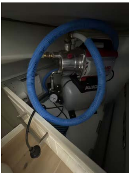
Viser vannpumpe plassert i skap på kjøkkenet.
