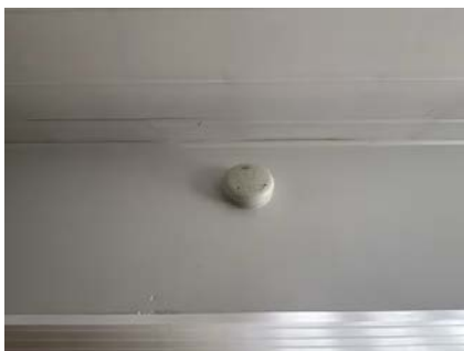
Viser brannvarsling montert på drager i stue.
