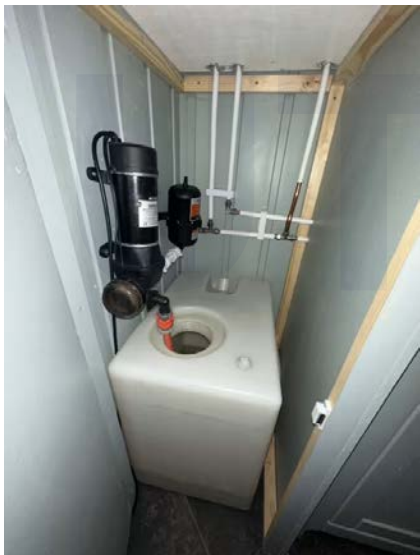
Viser plastdunk og vannpumpe i sanitærrom.
