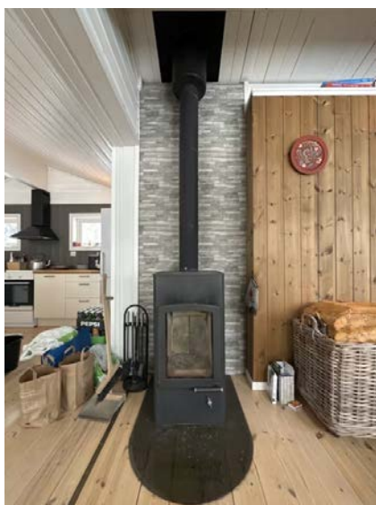
Viser ildsted montert i stue.
