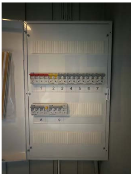
Viser sikringsskap på soverom.
