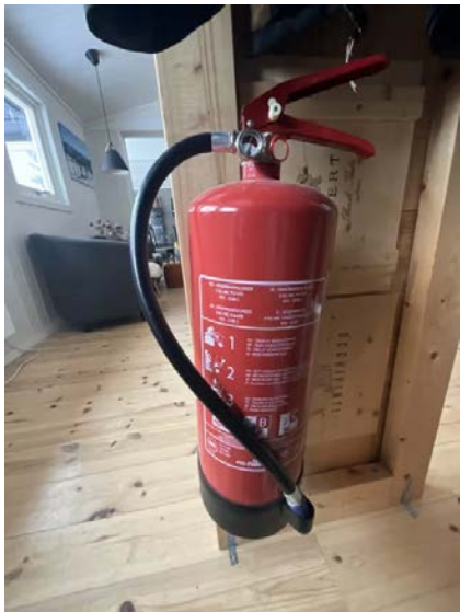
Viser brannslukningsapparat fra 2021.
