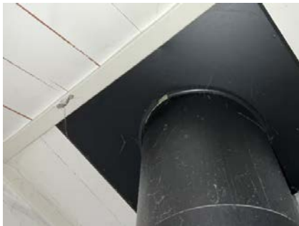
List rundt pipa må undersøkes.
