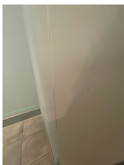
Oppsprekking av plateskjøter i våtsone.
