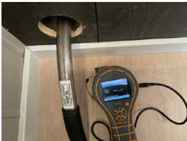
Fuktmåling fra stue mot dusjhjørne på bad.
