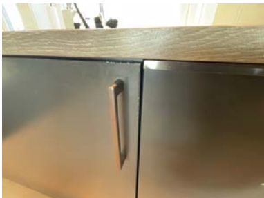
Avskalling av maling på enkelte fronter.
