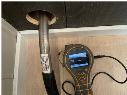
Fuktmåling fra stue mot dusjhjørne på bad.
