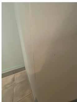
Oppsprekking av plateskjøter i våtsone.
