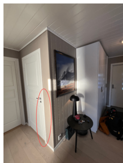
Skader etter hundehold på karmplaster ved dør.
