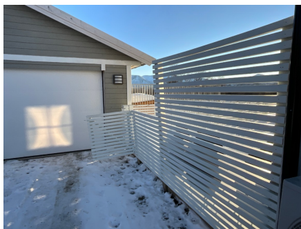
Rekkverk ut fra bolig mot garasje er løst og skjevt.
