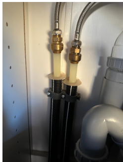
Utbedring av tettemuffer utført av eier etter befarings. Billedokumentasjon tilsendt 09.02.2026.
