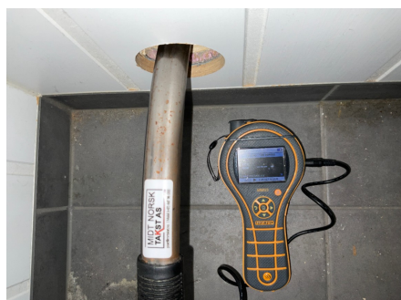
Fuktmåling bak vaskemaskin på vaskerom.
