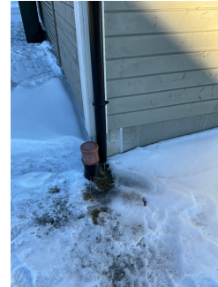
Taknedløp treffer ikke oppstikk for avløp i grunn.
