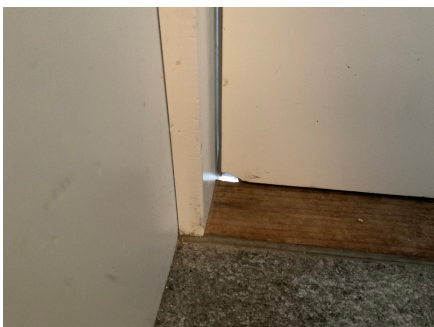
Mindre skade i nedre hjørnet.
