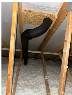
Isolert lufterør på kaldloft, Utført av eier etter befarings. Billedokumentasjon tilsendt 09.02.2026.
