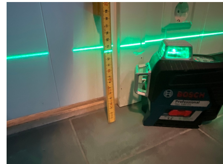
Laser plassert ved dørterskel.
