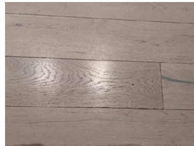
Skadet gulvskjøt. Bildet er tatt etter liming av gulvskjøt. Arbeidet ble utført av eier etter besiktigelse og er ikke kontrollert av takstingeniør. Billedokumentasjon tilsendt 09.02.2026.
