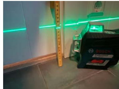
Laser plassert ved dørterskel.
