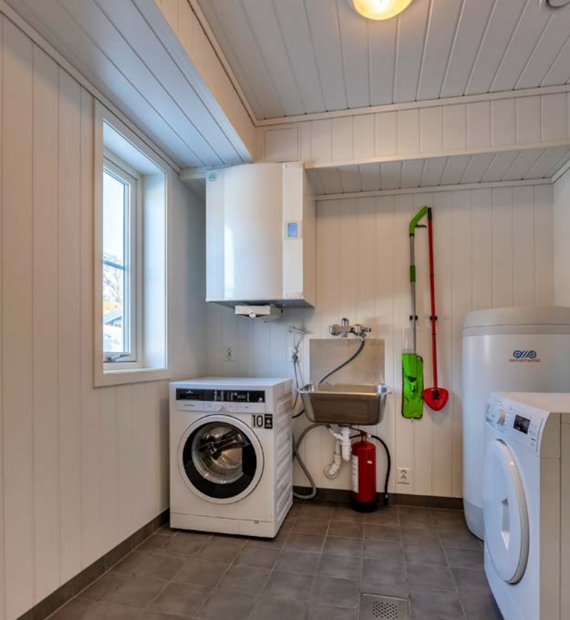
Praktisk vaskerom i tilknytning til inngangspartiet - Rommet huser også mye av boligens tekniske utstyr
