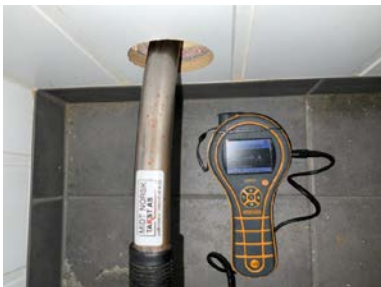
Fuktmåling bak vaskemaskin på vaskerom.
