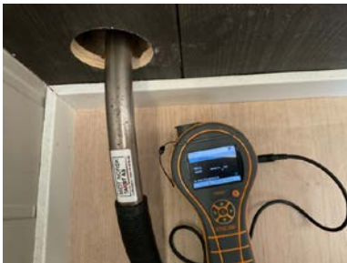
Fuktmåling fra stue mot dusjhjørne på bad.
