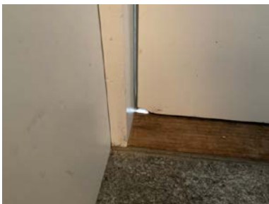
Mindre skade i nedre hjørnet.
