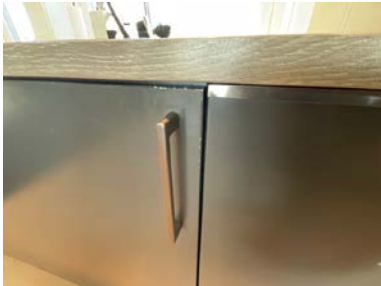
Avskalling av maling på enkelte fronter.
