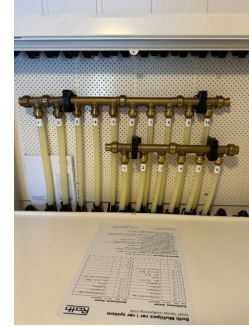
Merking av rørskap utført av eier etter befarings. Billedokumentasjon tilsendt 09.02.2026.
