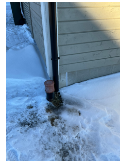
Taknedløp treffer ikke oppstikk for avløp i grunn.
