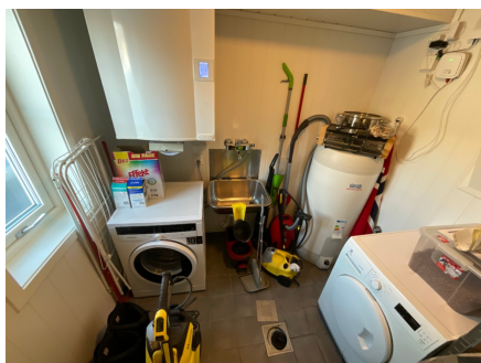
Varmtvannberederen er plassert i bildets høyre hjørne på vaskerom.
