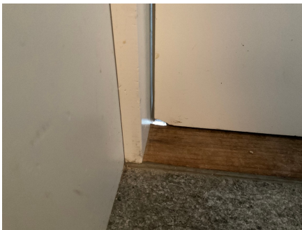
Mindre skade i nedre hjørnet.
