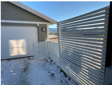
Rekkverk ut fra bolig mot garasje er løst og skjevt.
