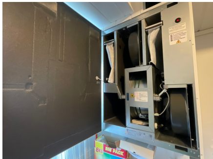
Hovedenhet er plassert på vaskerom.
