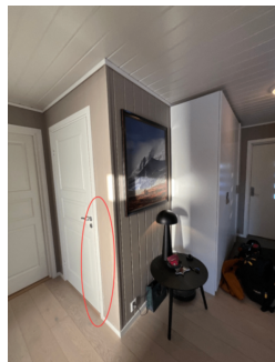
Skader etter hundehold på karmplater ved dør.
