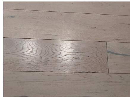
Skadet gulvskjøt. Bildet er tatt etter liming av gulvskjøt. Arbeidet ble utført av eier etter besiktigelse og er ikke kontrollert av takstingeniør. Billedokumentasjon tilsendt 09.02.2026.
