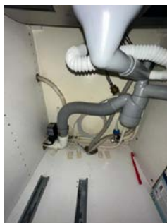
Røropplegg i kjøkkenbenk med Waterguard
