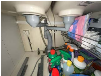
Avløpsrør i plast ført mot støpejern.
