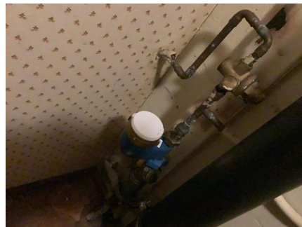
Hovedstoppekran og vannmåler.
