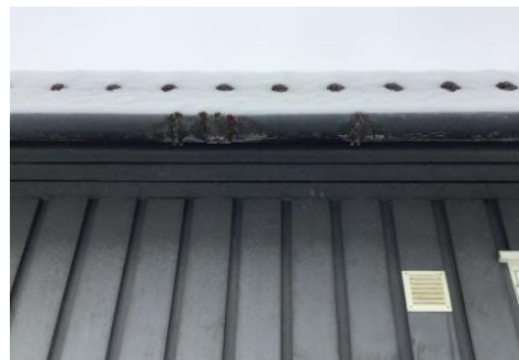
Det er registrert korrodering av renne.
