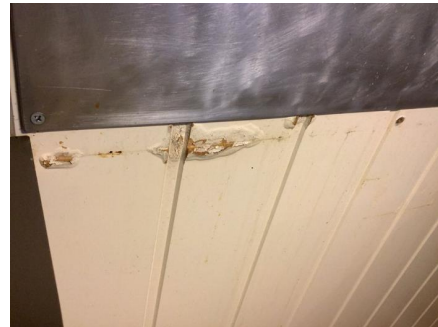
Noe svellemerker på vegg bak komfyr.
