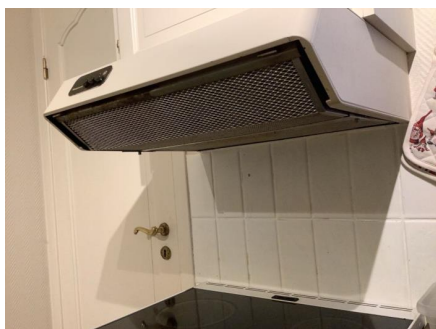
Lav høyde på avtrekksvifte.
