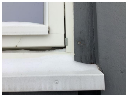
Kledningen har småsprekker i underkant og rundt vinduer.
