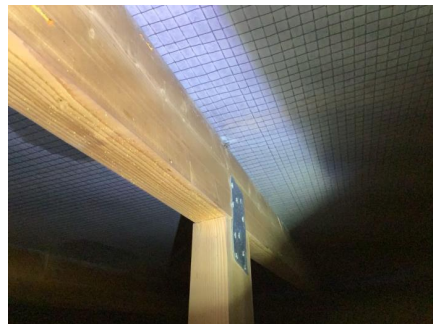
Enkelte småhull i undertaksduken.
