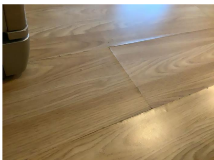
Laminat har svelleskader i vindfang.
