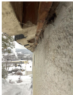
Lufting bak kledning er ikke ihht dagens krav.
