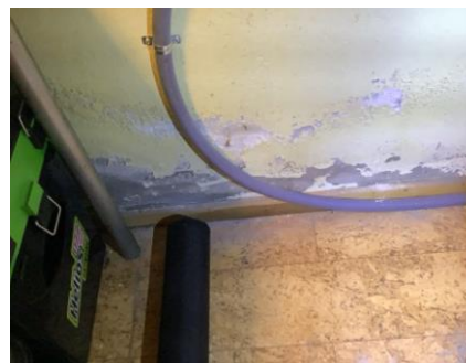
Det er saltutslag i kjellervegg.
