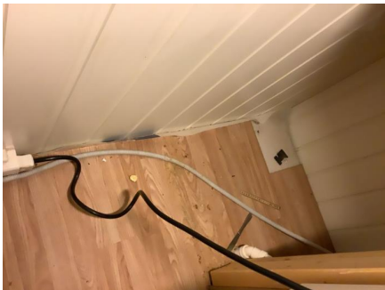
Manglende laminat på gulv i hjørnet.
