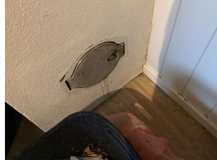
Feieluken er plassert for nærme brennbart materiale.
