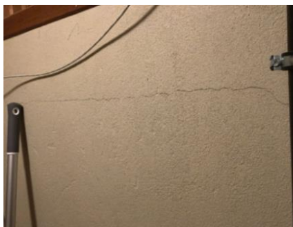
Horisontal sprek/riss i bakvegg mot gårdsplass.
