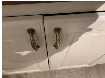
Noe brukslitasje på skapdører.
