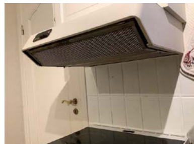
Lav høyde på avtrekksvifte.
