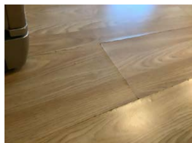
Laminat har svelleskader i vindfang.
