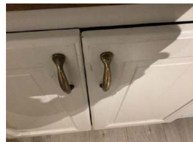
Noe bruksslitasje på skapdører.
