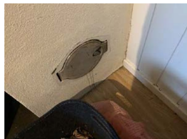
Feieluken er plassert for nærme brennbart materiale.
