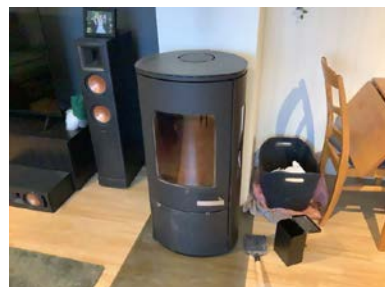
Rentbrennende vedovn i underetasje/kjeller.
