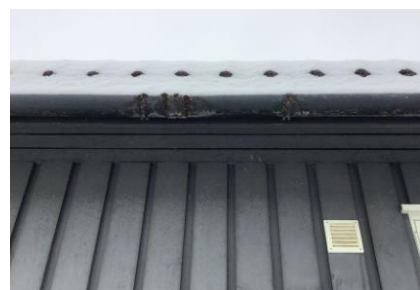
Det er registrert korrosjon av renne.
