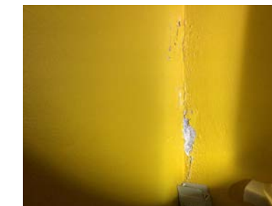
Det er saltutslag i kjellervegg.
