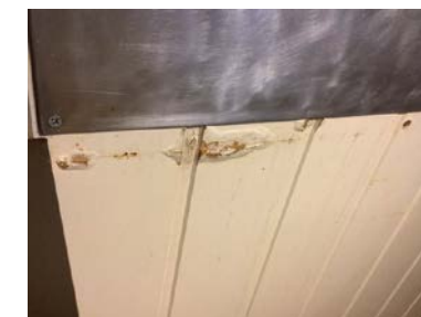
Noe svellemerker på vegg bak komfyr.
