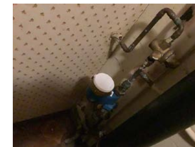
Hovedstoppekran og vannmåler.
