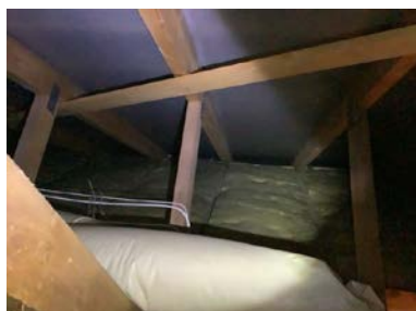
Isolasjon dekker delvis lufting fra raft og ved skråtak.
