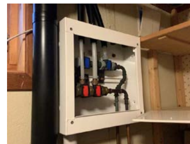
Rørskap for nyere bad i 1. etasje.
