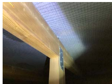
Enkelte småhull i undertaksduken.
