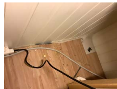
Manglende laminat på gulv i hjørnet.
