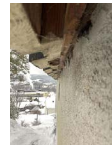
Lufting bak kledning er ikke iht dagens krav.
