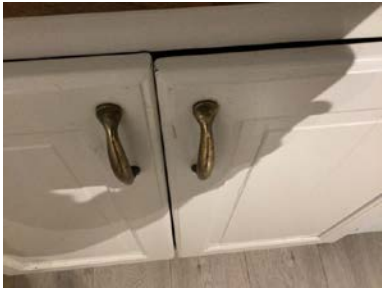
Noe bruksslitasje på skapdører.
