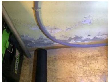
Det er saltutslag i kjellervegg.
