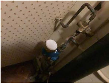
Hovedstoppekran og vannmåler.
