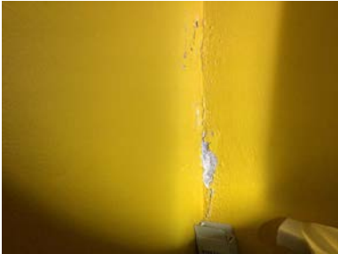
Det er saltutslag i kjellervegg.
