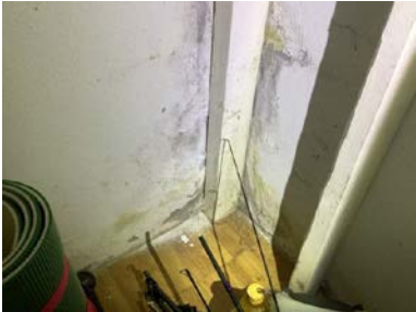
Det er saltutslag og avflassing i kjellervegg.
