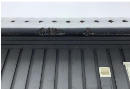
Det er registrert korrodering av renne.
