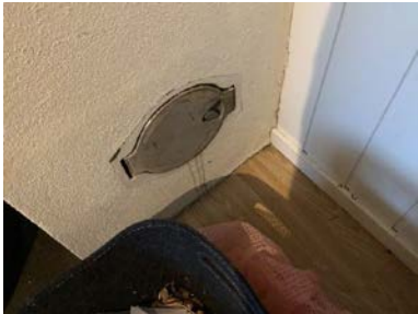
Feieluken er plassert for nærme brennbart materiale.
