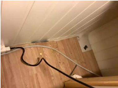
Manglende laminat på gulv i hjørnet.
