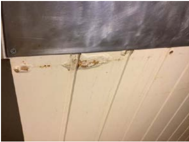
Noe svellemerker på vegg bak komfyr.
