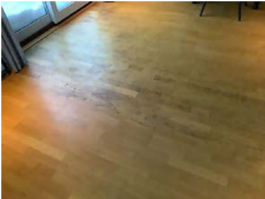
Parkett er slitt foran balkongdør.
