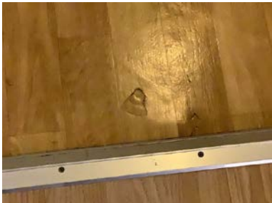
Skade i vinylbelegg på gulv.
