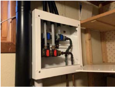
Rørskap for nyere bad i 1. etasjen.
