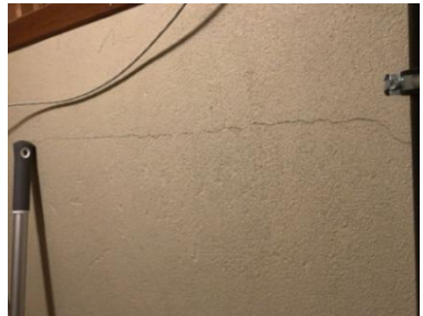
Horisontal sprekk/riss i bakvegg mot gårdsplass.
