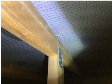
Enkelte småhull i undertaksduken.
