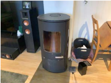
Rentbrennende vedovn i underetasje/kjeller.
