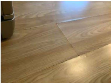
Laminat har svelleskader i vindfang.
