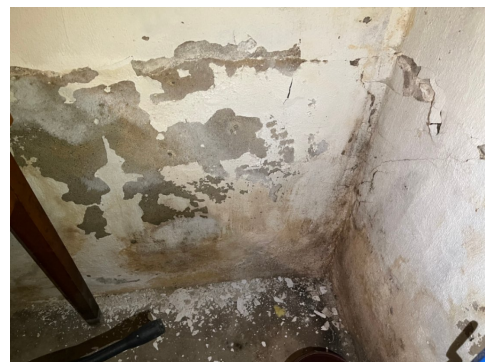
Saltutslag og løs puss er tegn på fukt.
