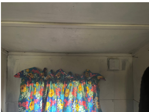
Fuktskader i himling og på vegger.
