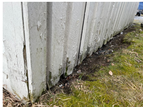
Trekledning har råteskader.
