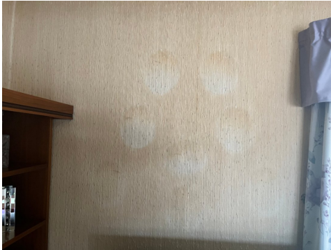
Falmet overflate i stue.
