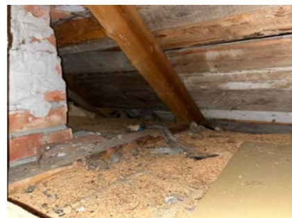
Møneloft isolert med bl.a. sagflis.
