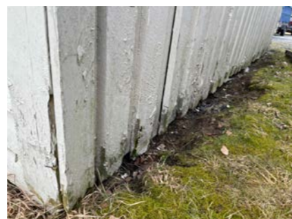
Trekledning har råteskader.
