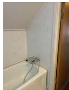
Skråhimling og dør kan bli utsatt for vannsprut.
