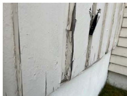
Kledning har slitasje.
