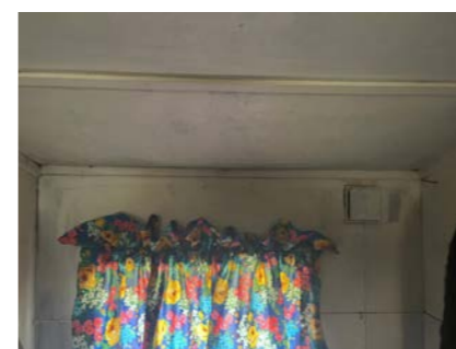
Fuktskader i himling og på vegger.
