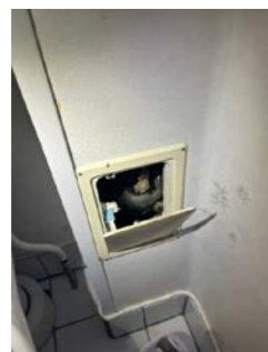
Luke på bad til avløpslufting med stakeluke.
