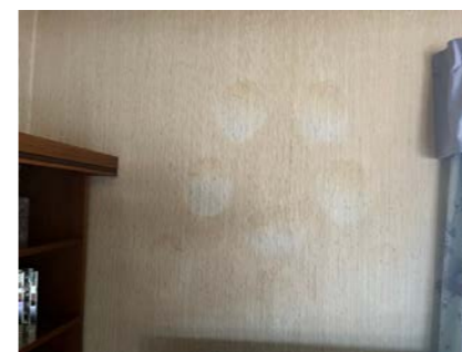
Falmet overflate i stue.
