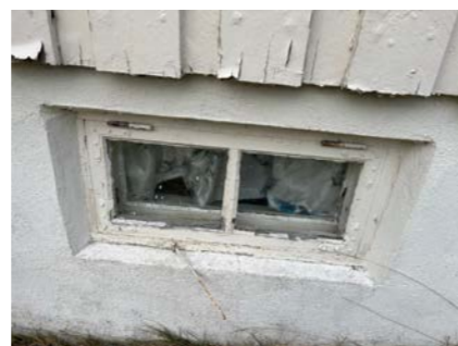
Eldre kjellervindu med slitasje.
