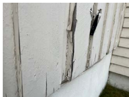
Kledning har slitasje.
