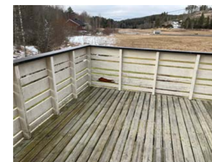
Veranda må utbedres.
