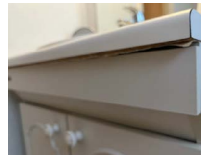
Benkeplate har fuktskade i underkant.
