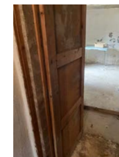
Dører i kjeller må utbedres.
