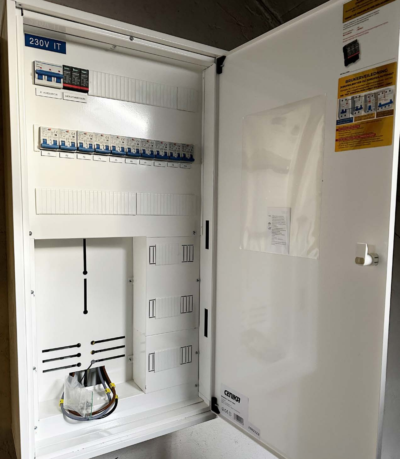
Det er installert nytt sikringskap med automatsikringer i enheten, og det mangler kun måler før anlegget kan tas i bruk
