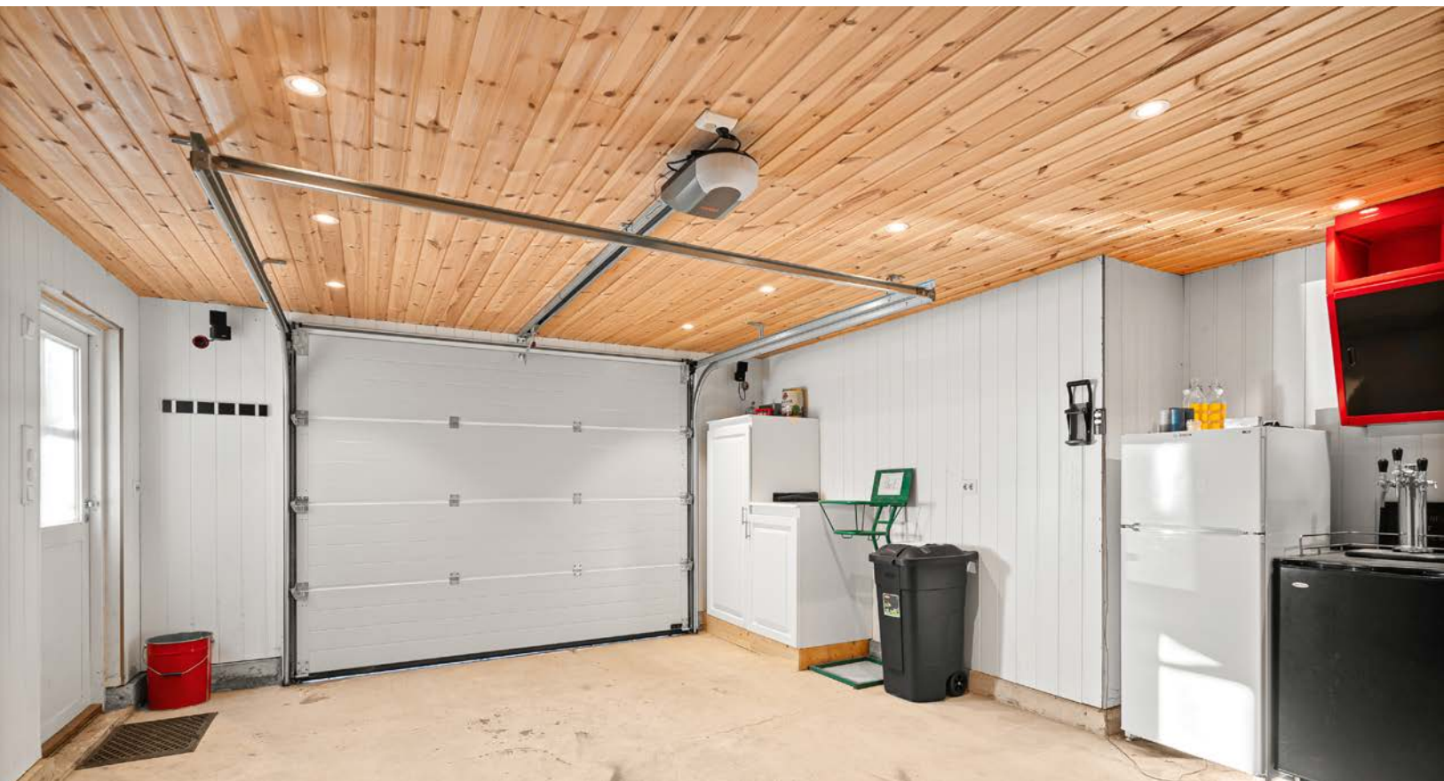
Spotter i taket i garasjen og elektrisk portåpner.
