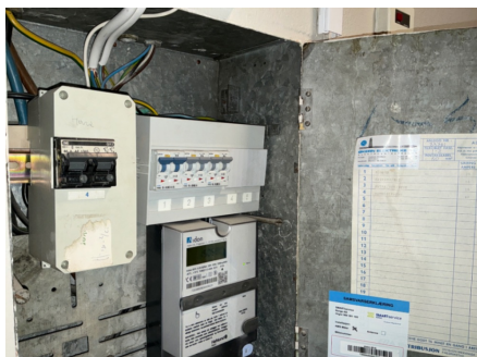
Automatsikringer i sikringsskap plassert i gang/fellesareal.
