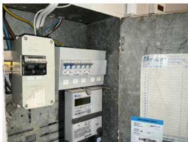
Automatsikringer i sikringsskap plassert i gang/fellesareal.
