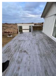
Mangler beslag mellom gulv og vegg.
