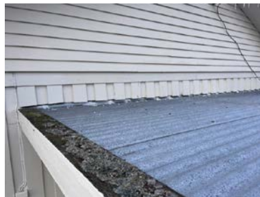
Kort avstand fra underkant av kledding til taktekkning og råte på dekkbord.
