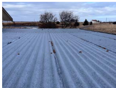
Litt heng i takkonstruksjonen.
