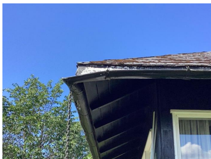
Takrenne henger ned på hjørne mot sør-øst.
