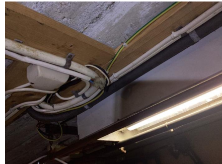
Åpen kobling i kjeller.
