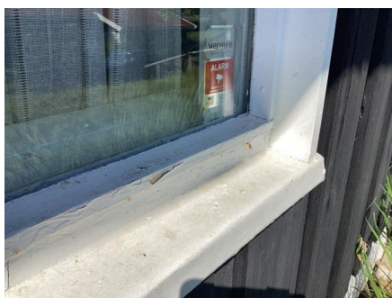
Eksempel på slitasje.
