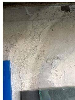
Eksempel på sprekke på innsiden av grunnmur.
