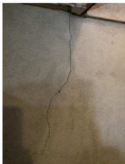
Eksempel på sprekke på innsiden av grunnmur.
