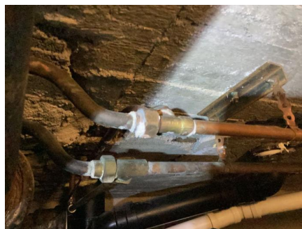
Stedvis korrosjon på skjøter.
