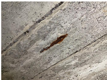
Eksempel på synlig armering som ruster.
