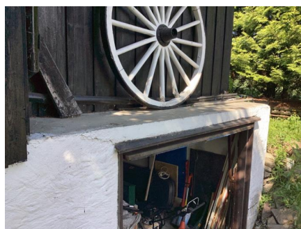
Del over garasje har ikke tekking.
