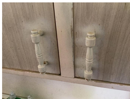
Eksempel på slitasje.
