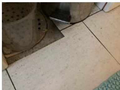
Det er ikke tett og klemt avslutning mellom vinylfliser og sluk.
