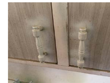
Eksempel på slitasje.
