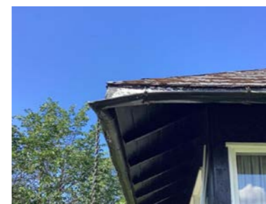
Takrenne henger ned på hjørne mot sør-øst.
