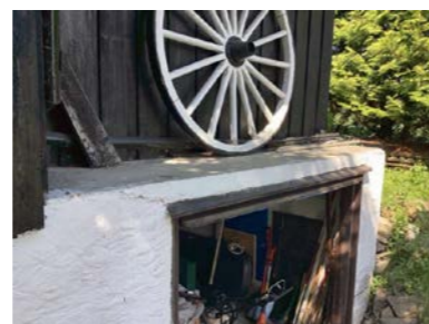
Del over garasje har ikke tekking.
