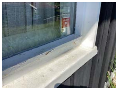
Eksempel på slitasje.
