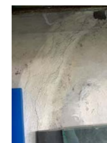
Eksempel på sprekke på innsiden av grunnmur.
