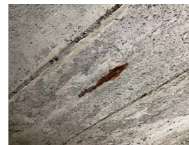
Eksempel på synlig armering som ruster.
