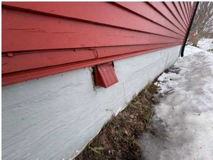
Kledningen er ikke ventilert.
