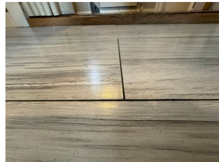
Fuktsvellinger i laminatgulvet.
