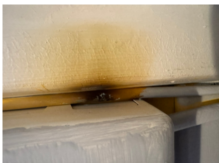
Tegn til varmgang på ledning over en koblingsboks.
