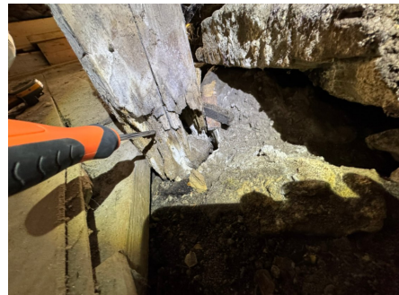
Råteskade i trevirke.
