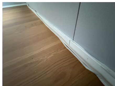
Eksempel på løs ledning.
