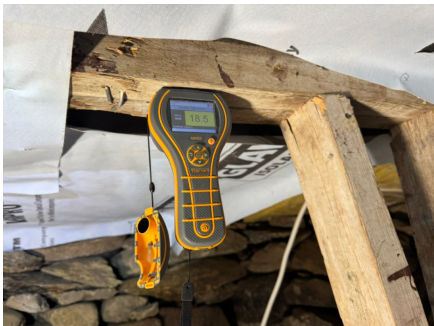
Fuktmåling i drager.
