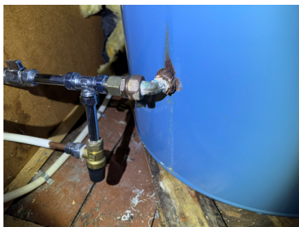
Rust på rørkoblingen til varmtvannstanken.
