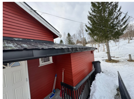
Manglende snøfangere hvor folk kan ferdes.
