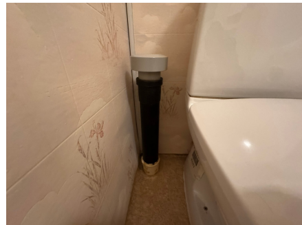
vakumventil på badet.
