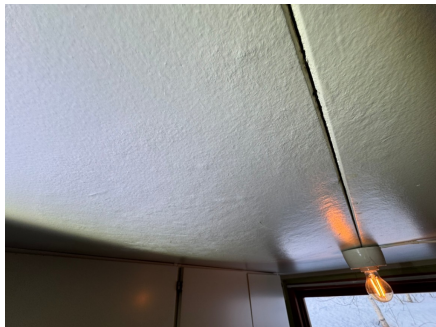
Fuktskjolder i taket.
