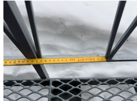
Åpninger i rekkverket.
