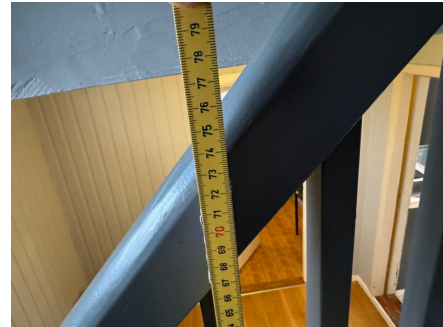
Høyde på rekkverket.
