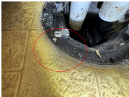
Sluk. Skadet vinylbelegg.
