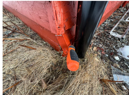
Eksempel på råteskadet kledning.
