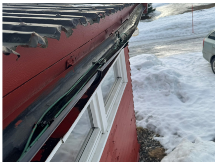
Skader på takrenne.
