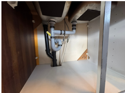
vakumventil under vasken på kjøkkenet.
