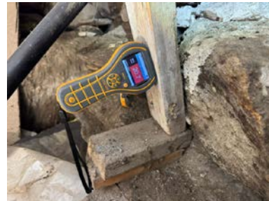
Fuktmåling i søyle.
