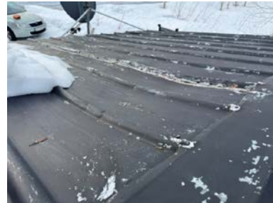
Store bulker i taktekkingen.
