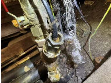
Lekkasje på vannledningen i krypekjelleren.
