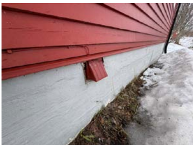
Kledningen er ikke ventilert.
