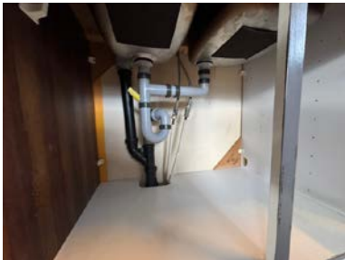
vakumventil under vasken på kjøkkenet.
