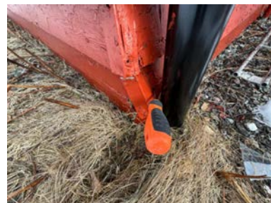
Eksempel på råteskadet kledning.
