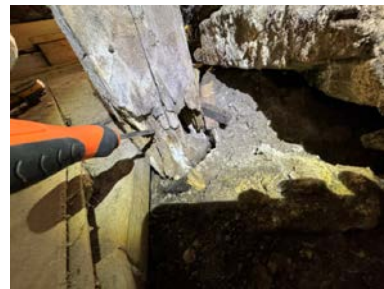
Råteskade i trevirke.
