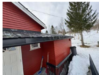
Manglende snøfangere hvor folk kan ferdes.
