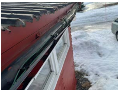
Skader på takrenne.
