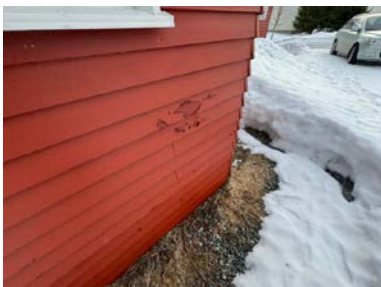
Kledningen går hel ned til bakkenivå.
