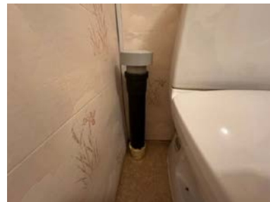
vakumventil på badet.
