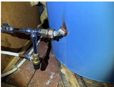
Rust på rørkoblingen til varmtvannstanken.
