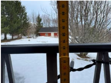
Høyden på rekkverket.
