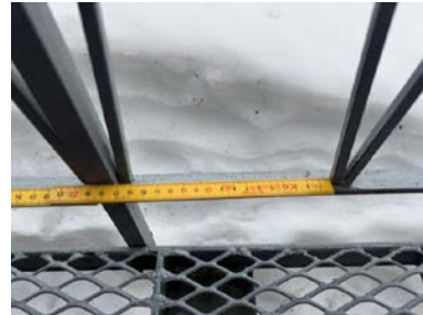
Åpninger i rekkverket.
