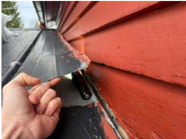
Løs takplate, det er ikke beslag i overgang vegg tak.
