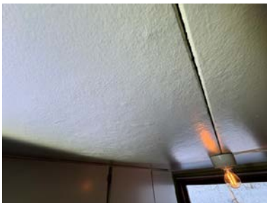
Fuktskjolder i taket.
