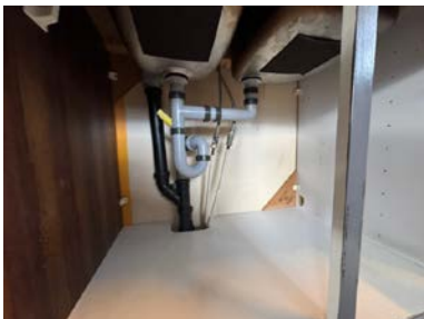
vakumventil under vasken på kjøkkenet.
