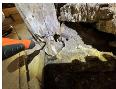
Råteskade i trevirke.
