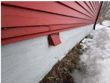
Kledningen er ikke ventilert.
