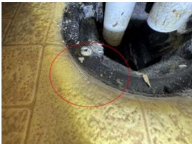
Sluk. Skadet vinylbelegg.
