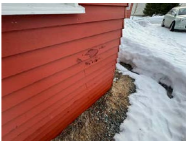
Kledningen går hel ned til bakkenivå.
