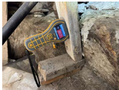
Fuktmåling i søyle.
