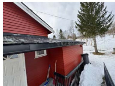
Manglende snøfangere hvor folk kan ferdes.
