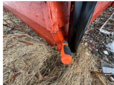
Eksempel på råteskadet kledning.
