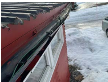
Skader på takrenne.
