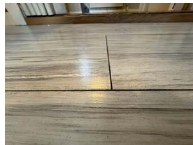
Fuktsvellinger i laminatgulvet.
