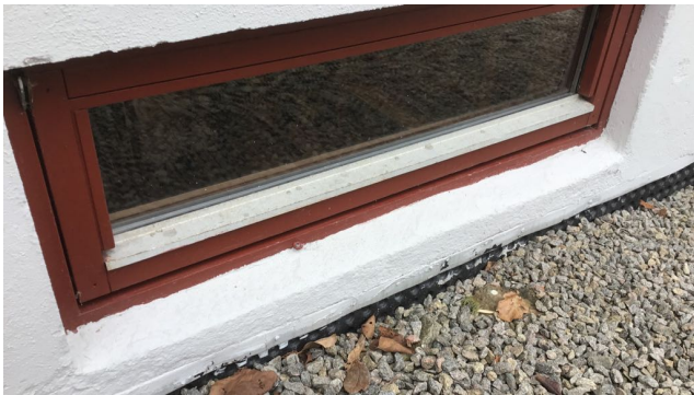
Mangler beslag under vindu
