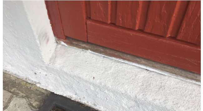
Mangler beslag under dør
