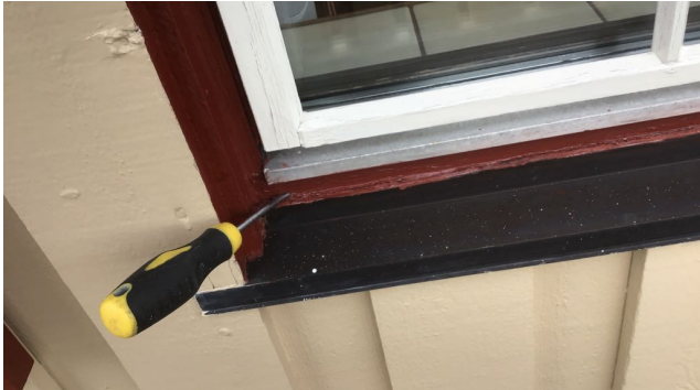
Fukt i nedkant stuevinduer
