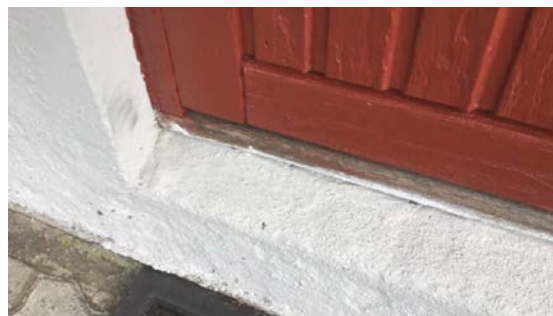
Mangler beslag under dør
