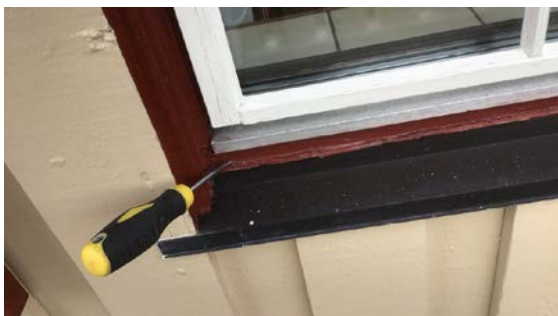
Fukt i nedkant stuevinduer
