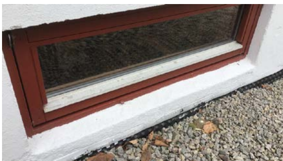
Mangler beslag under vindu
