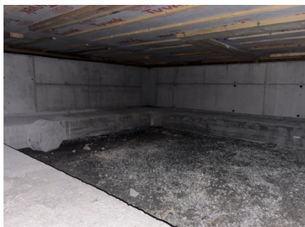
Stedvis fukt mot grunn/ grus.
