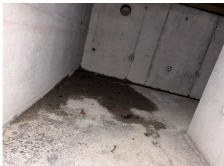
Synlig fukt i rom under utebod.
