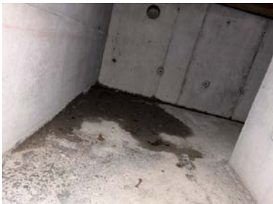
Synlig fukt i rom under utebod.
