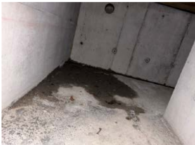
Synlig fukt i rom under utebod.
