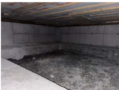
Stedvis fukt mot grunn/ grus.
