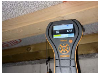
Målingen viser et akseptabelt fuktinnhold uten risiko for en skadeutvikling i form av sopp-/råteskader.
