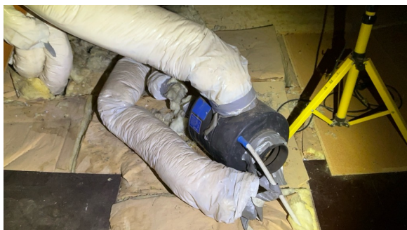
Tidligere loftsvifte fra våtrom virker ikke.
