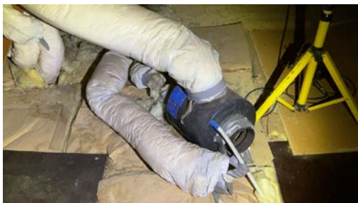
Tidligere loftsvifte fra våtrom virker ikke.
