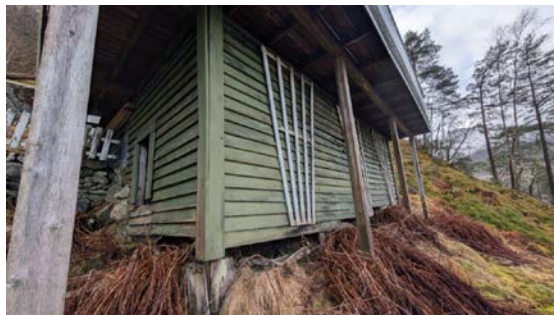
Det er råte på vegg under terrasse.
