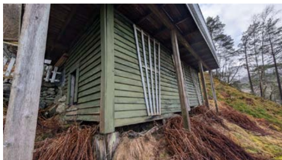
Det er råte på vegg under terrasse.
