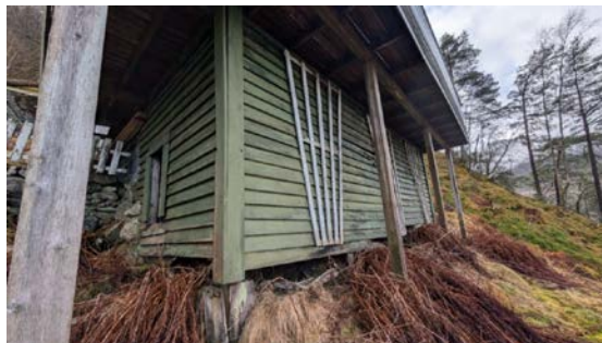
Det er råte på vegg under terrasse.
