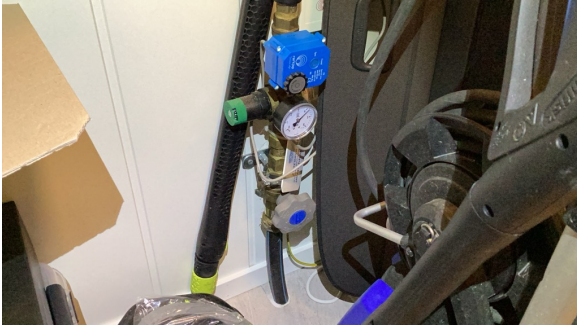
Stoppekran på bod.
