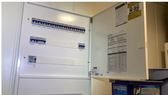
Sikringsskap på teknisk rom.
