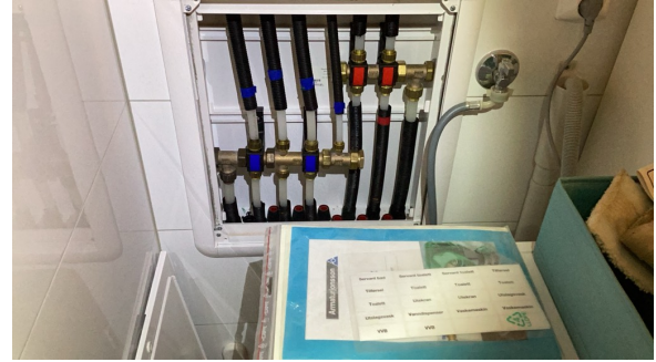
Fordelerskap på bad.
