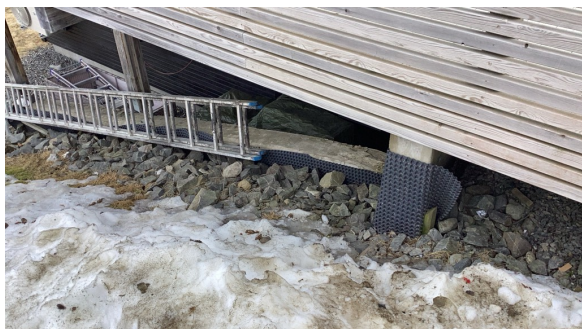
Grunnmursplast mot støttemur mangler avslutningslist i topp.
