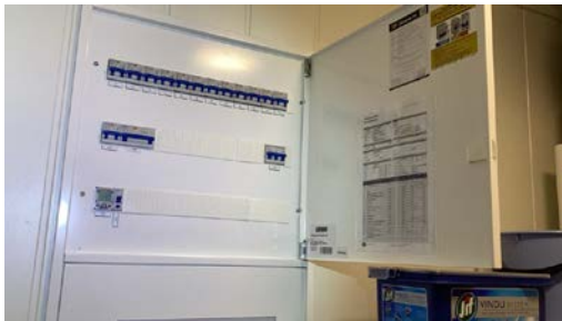
Sikringsskap på teknisk rom.
