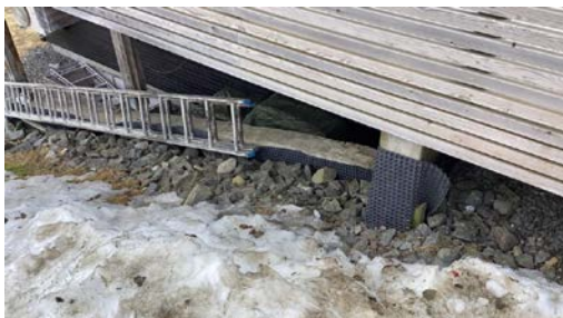
Grunnmursplast mot støttemur mangler avslutningslist i topp.
