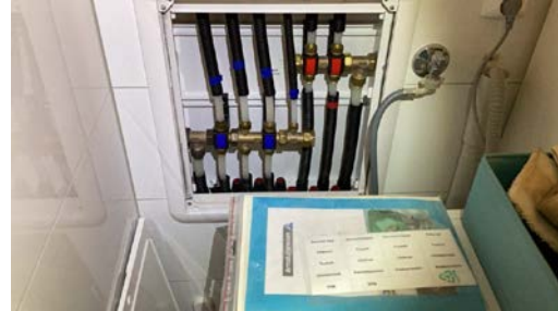
Fordelerskap på bad.
