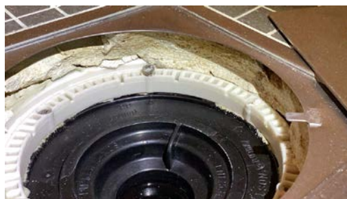
Skrue i sluk er ikke strammet nedtill.
