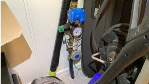
Stoppekran på bod.
