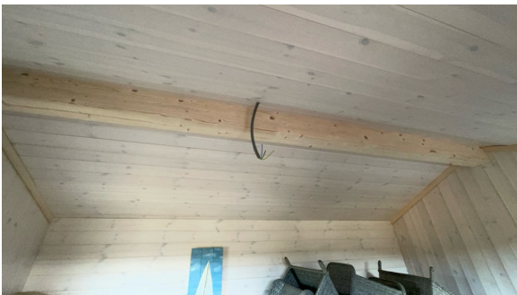
Åpne ledninger i bod som må utbedres.
