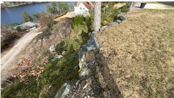
Fall på over 0.5m og 2 over 2m, forstøtningsmur.
