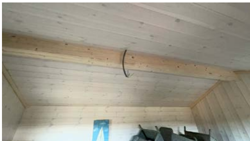
Åpne ledninger i bod som må utbedres.
