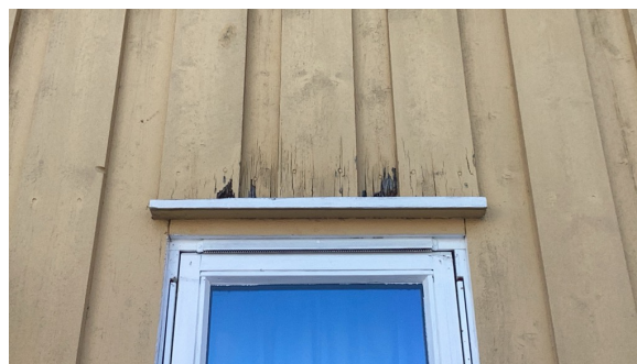
Eksempel på råte i kledning.
