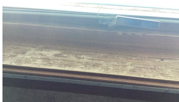
Eksempel på slitasje.
