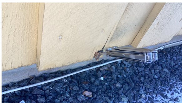
Eksempel på råte i kldning.
