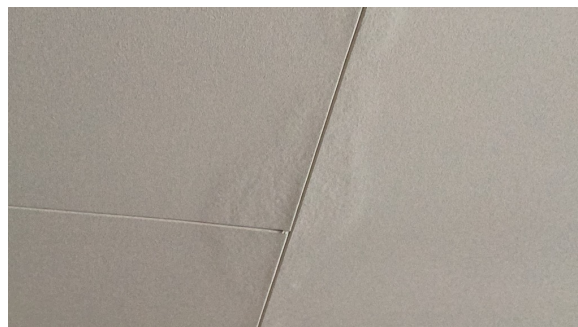
Svelleskade i himling i stue.
