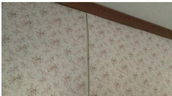
Tapet løsner i skjøter flere steder
