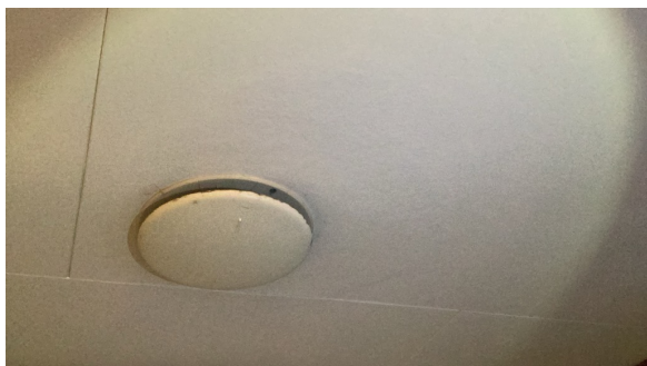
Svelling i himling ved ventil.
