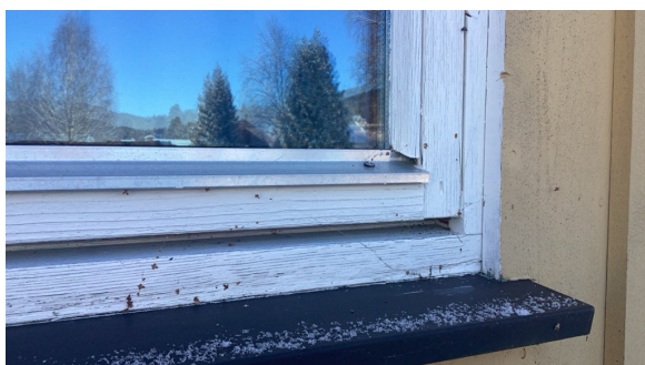
Eksempel på slitasje.
