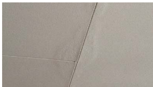
Svelleskade i himling i stue.
