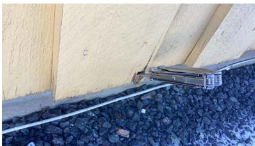
Eksempel på råte i kldning.
