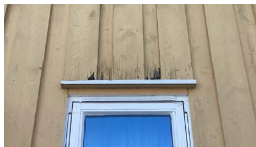
Eksempel på råte i kledning.
