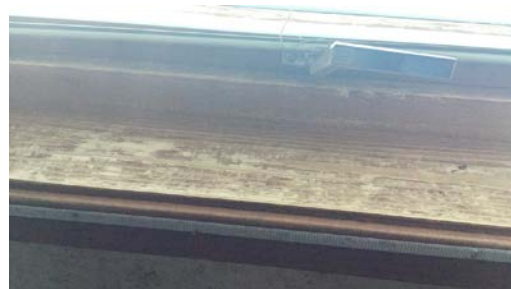
Eksempel på slitasje.
