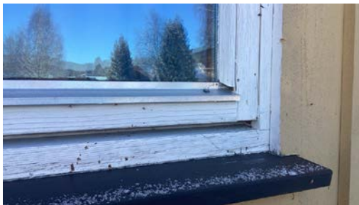
Eksempel på slitasje.
