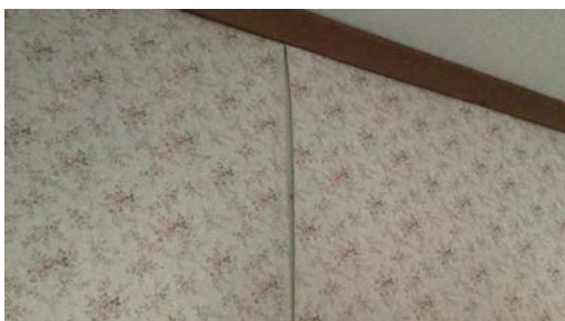
Tapet løsner i skjøter flere steder
