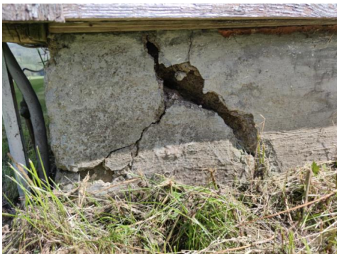
Sprekk i grunnmur mot nordvest.
