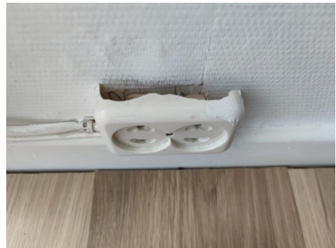
Skade på stikkontakt.
