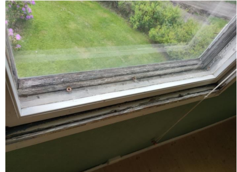
Vinduer er eldre og bærer preg av elde/slitasje.
