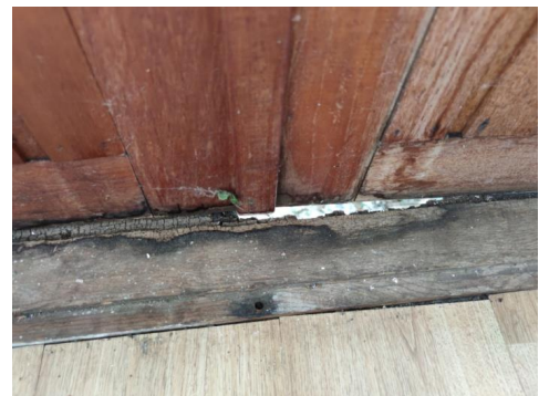
Råteskader i terrassedør.
