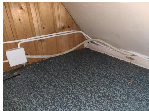
Kabel ikke festet tilstrekkelig.
